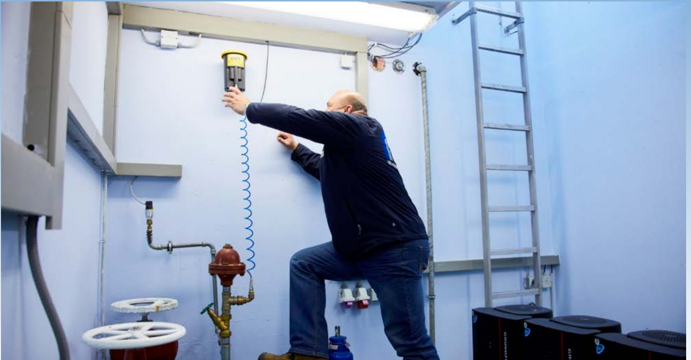
Roland Kainz controlla il sensore di pressione XiLog nella stazione di pompaggio Opping a valle. Invia dati tramite GSM al controller DDD a Wolkertsham.
