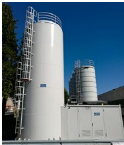
Il serbatoio esterno da 120 m 3 .
