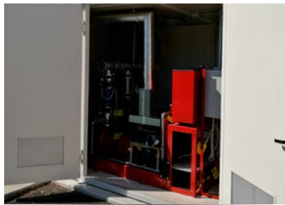
Il box Unifire presso la stazione di pompaggio antincendio.
