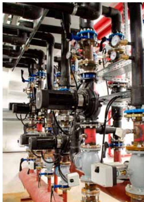
Foto: Impianto installato
