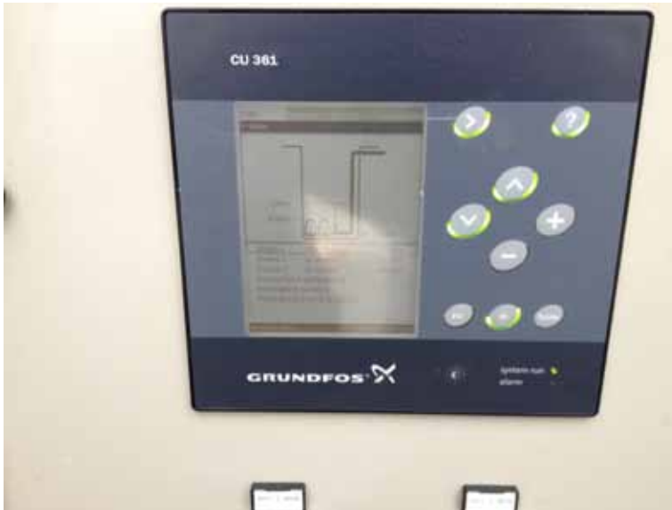
Foto: Quadro CU361 per monitorare la situazione
