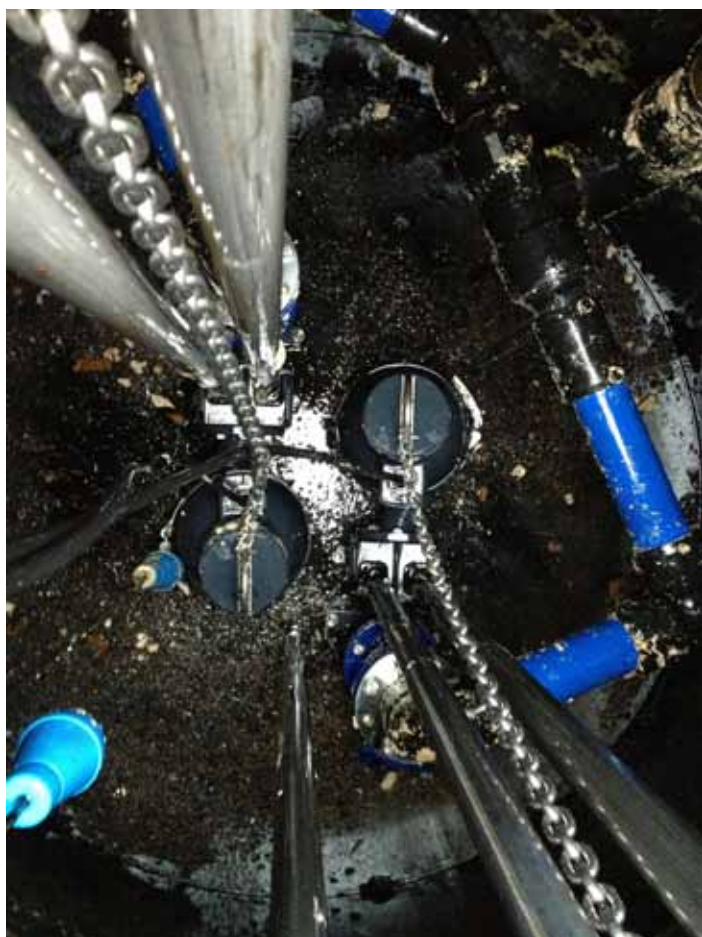
Foto: Installazione Pompe
