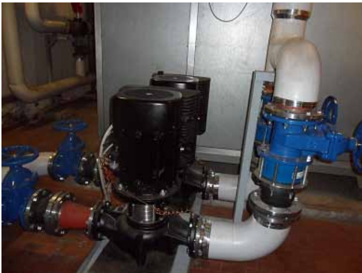
Foto: Installazione Pompe TPE Grundfos
