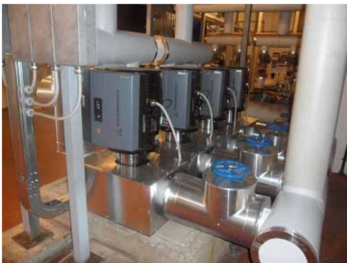
Foto: Installazione Pompe TPE Grundfos
