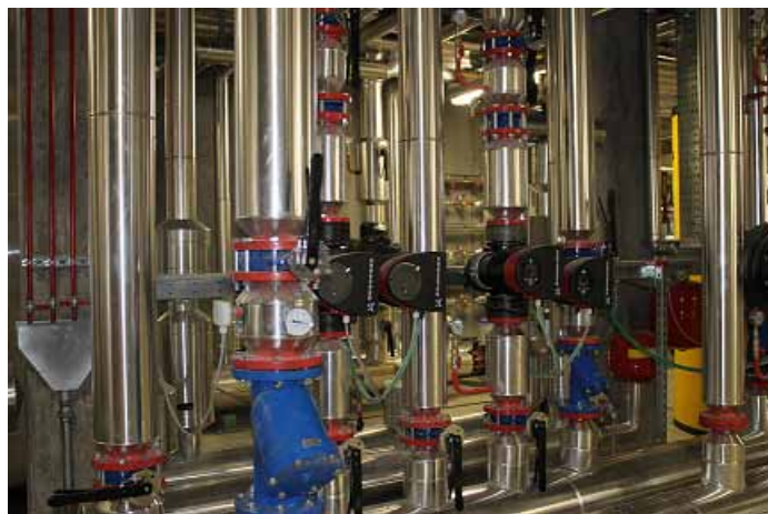
Foto: Installazione Pompe MAGNA3 Grundfos
