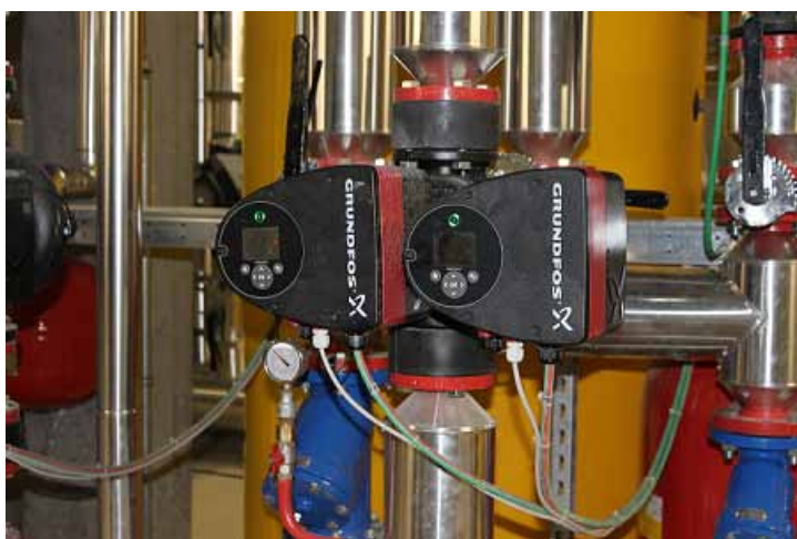
Foto: Installazione Pompe MAGNA3 Grundfos
